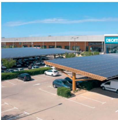
En 2024, ombrières photovoltaïques sur parking installées par Altarea Energies Renouvelables.
